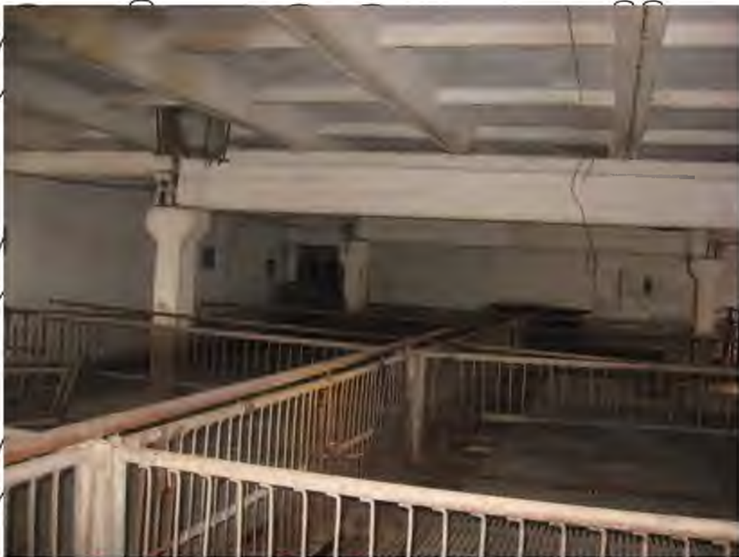
Рис.3 Станки для утримання глибокопоросних свиноматок Годівля нормована з корит. Роздавання корму вручну за допомогою вагонетки та відер. Напування за допомогою есскових автоматувалок ПБС-1.
