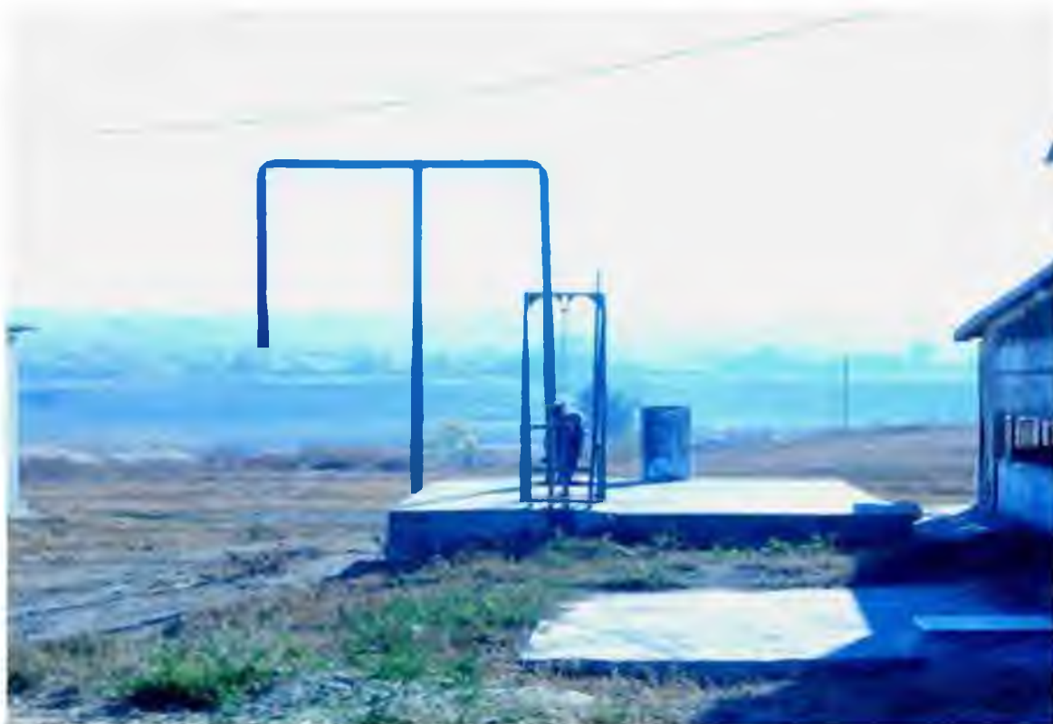
Видалення гнойових стоків з накопичувальних резервуарів (насос НЦІ-Ф-100)
