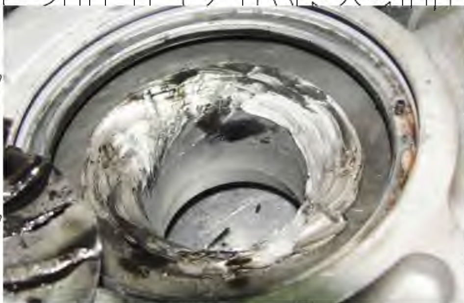
Рис. 3.5. Задири на корпусі равлика від крильчатки
