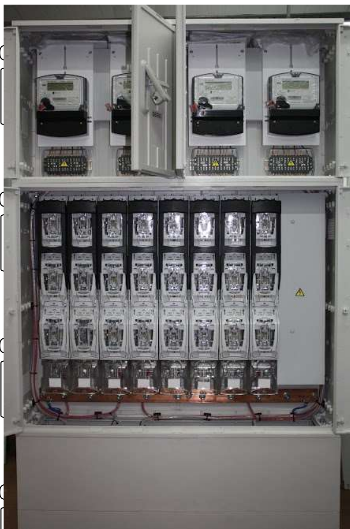
Рис. 1.1 - Вигляд станції РП НС після реконструкції (на базі шаф типу SKU).
