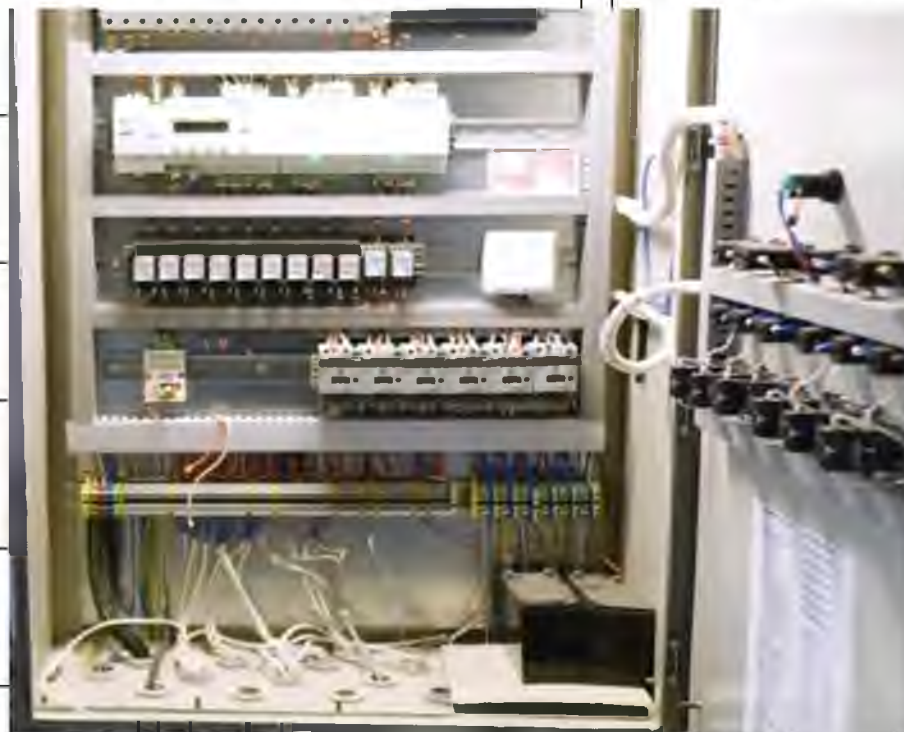
Рис. 1. Шафа автоматизації системи УЗВ.
