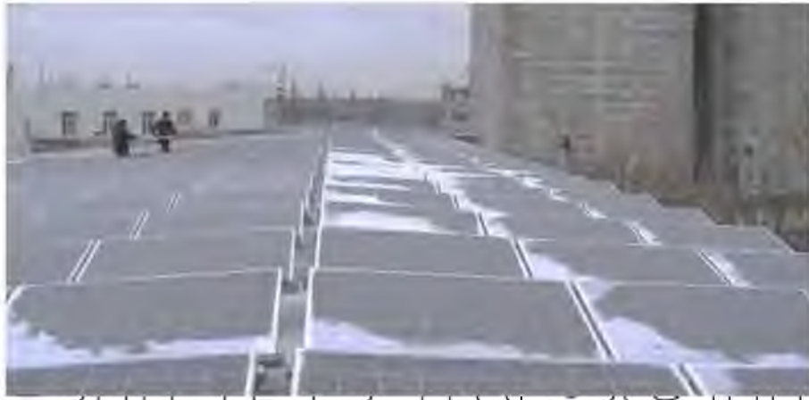
1.4. Дахова сонячна електростанція «Трак-Солар»
