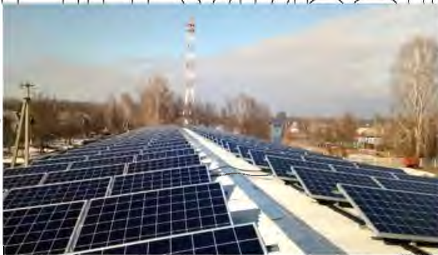
1.3. Дахова сонячна електростанція «Відродження»
