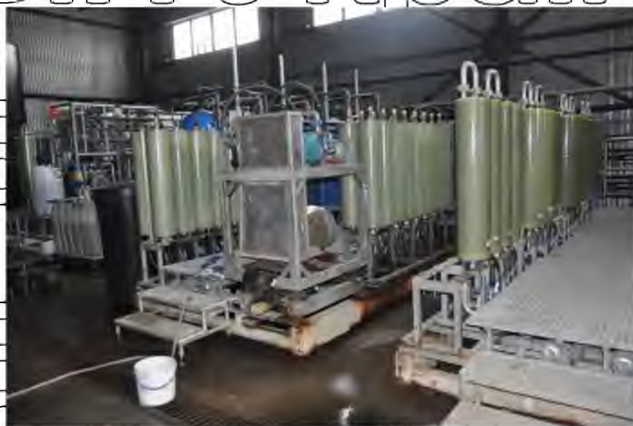
Рис. 3.5. Установки для очищення фільтрату
