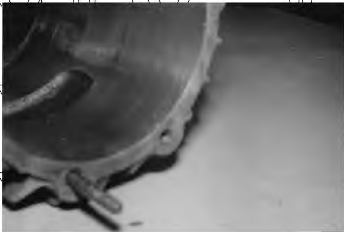
Рис. 2.2. Загальний вигляд знощеної поверхні корпусу насоса.
