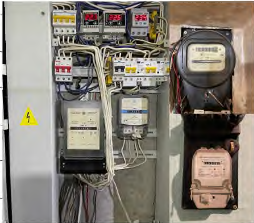
Рис. 3.1 Лічильники електричної енергії, які підлягають заміні
