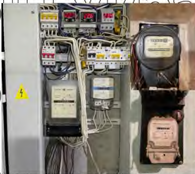
Рис. 4.1 Лічильники електричної енергії, які підлягають заміні
