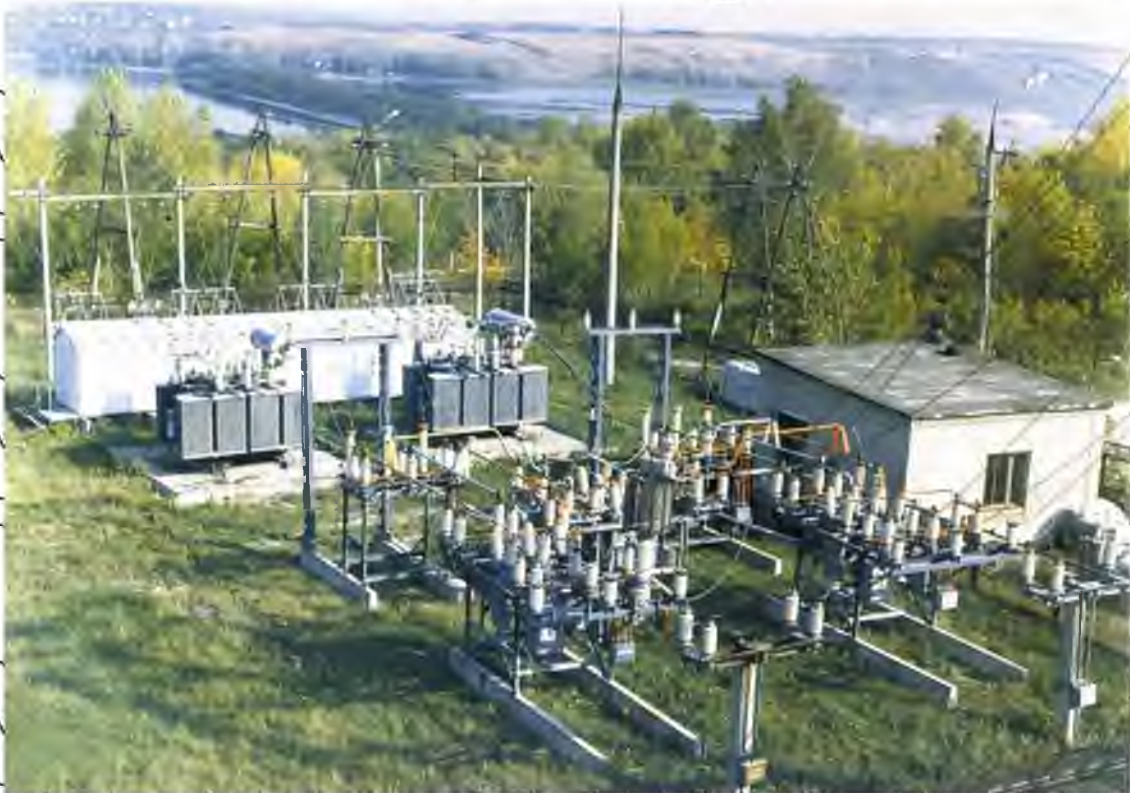
Рис. 1.1 Підстанція "Вулкан" 35/10 кВ
