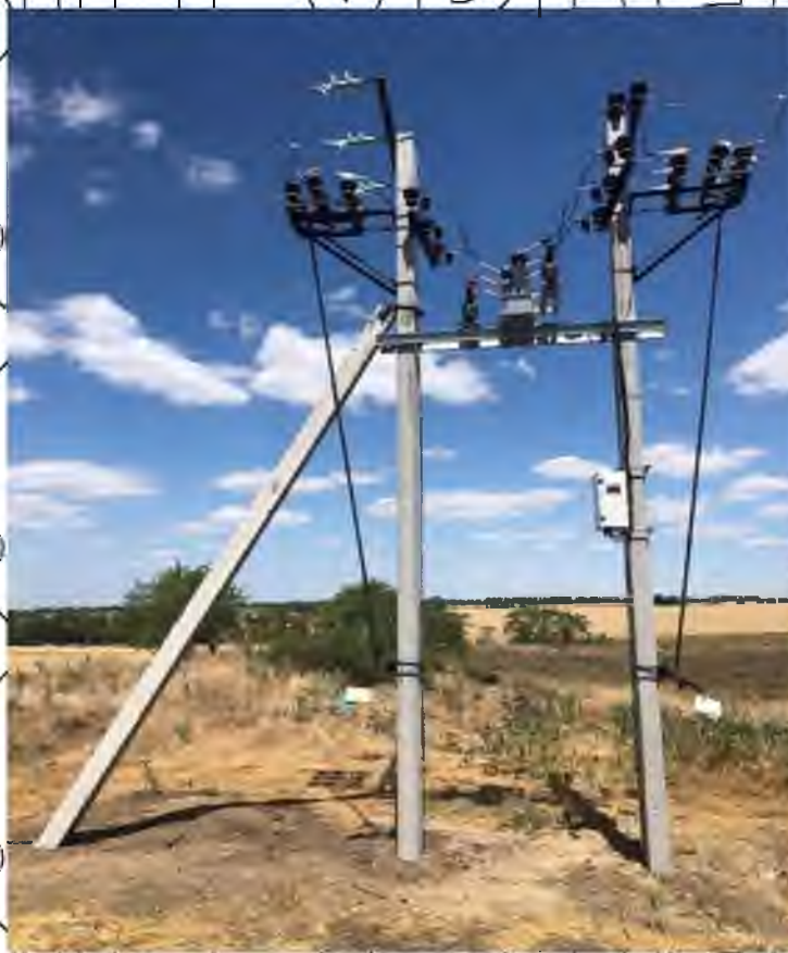
Рис. 5.4 Приклад встановлення реклоузера E-NEXT.
