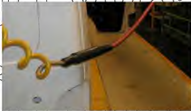
Рис. 19 а Металевий штуцер не ізолюваний
