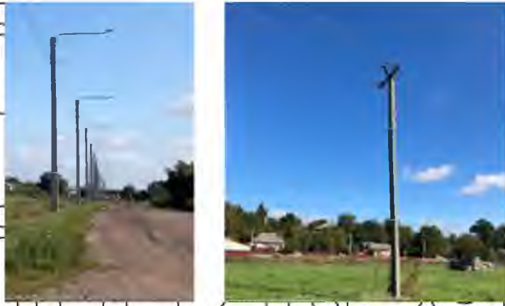
Рис. 3.6. Розміщення лінії електропередач (фото автора)
