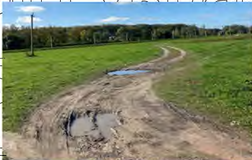
Рис. 3.3. Незадовільний існуючий стан ґрунтового покриття (фото автора)
