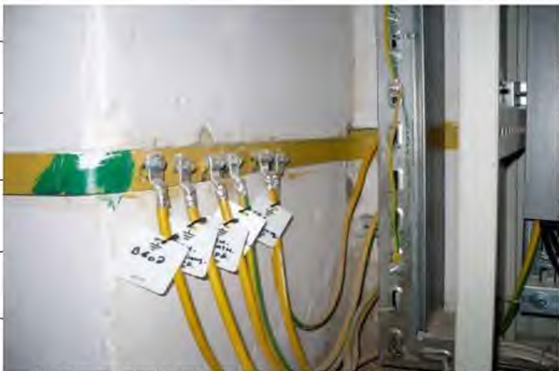
Рис. 6.1. Заземлення в електрощитовій
