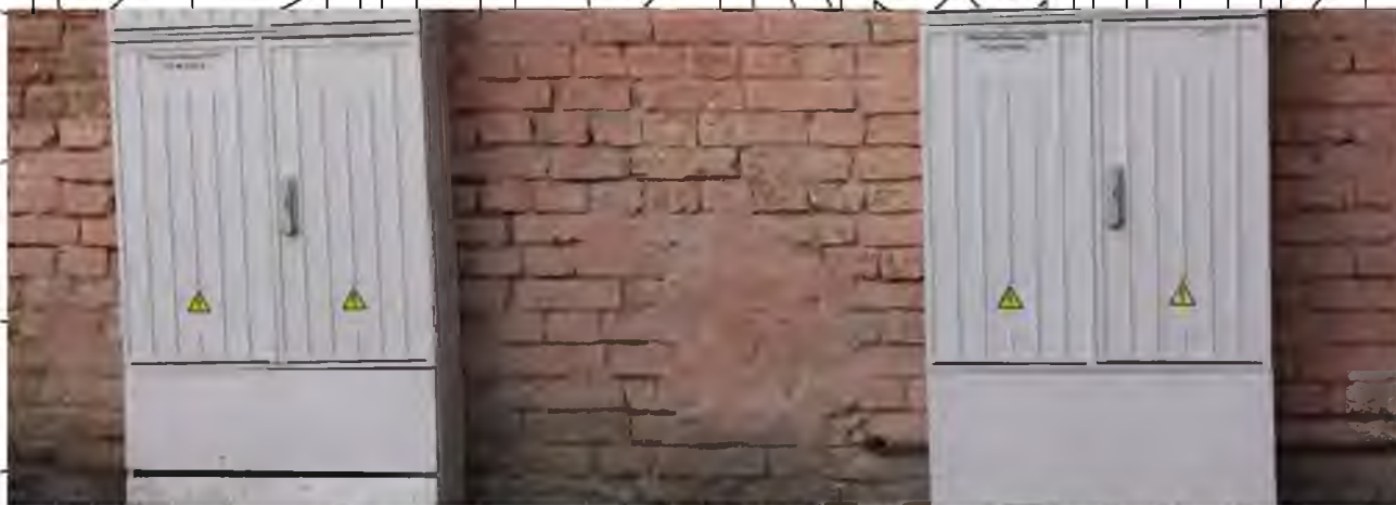
рис. 1.2. Зовнішній вигляд електророзподільних шаф типу SKU
