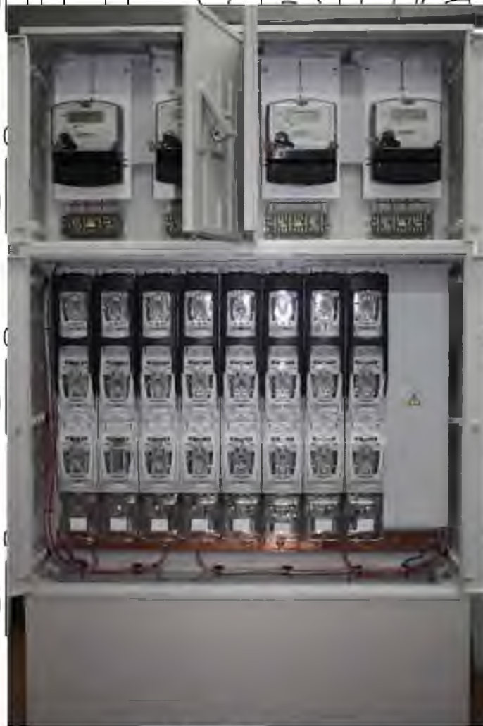
рис 1.1. Вид трансформаторної підстанції ІІІ ціля реконструкції (на основі електророзподільних шаф, тип SKU).
