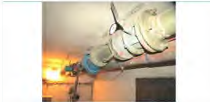
Фото вузла обліку теплової енергії
